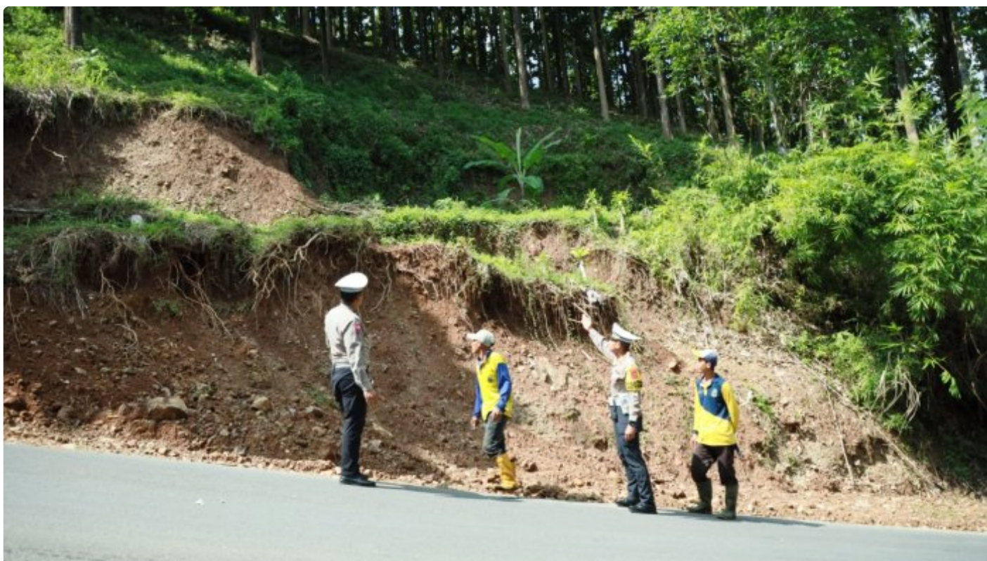
Survei Tanah Longsor di Cikidang Sukabumi, Acp Fiekry Himbau agar Pengendara selalu Waspada
